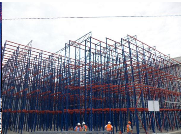
Sistema de racks estructurales
