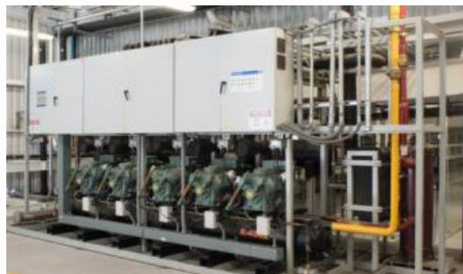
Rack de compresores
