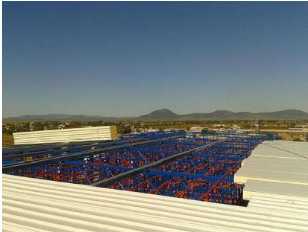
Sistema de racks combinado
