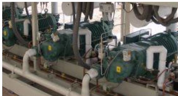
Compresores dentro del rack
