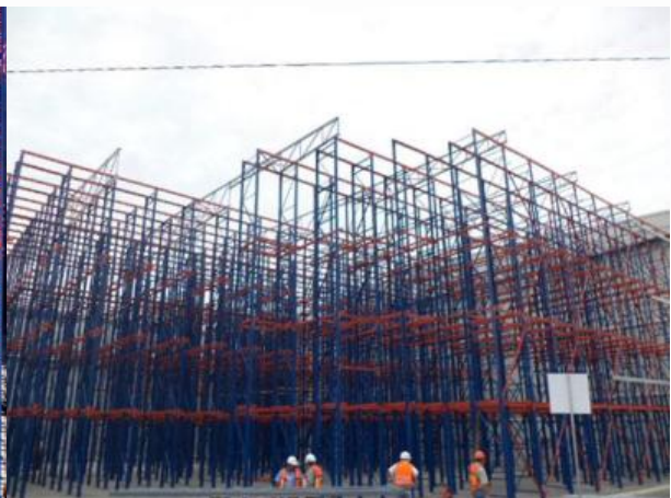
Sistema de racks estructurales
