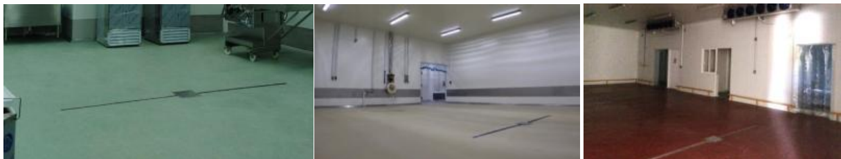
Canaletas en área de procesos
