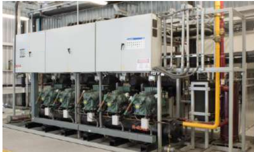
Rack de compresores
