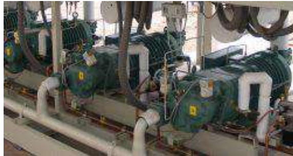
Compresores dentro del rack
