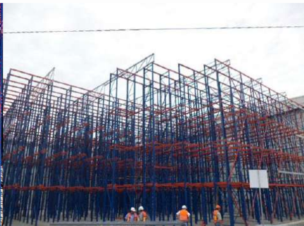
Sistema de racks estructurales
